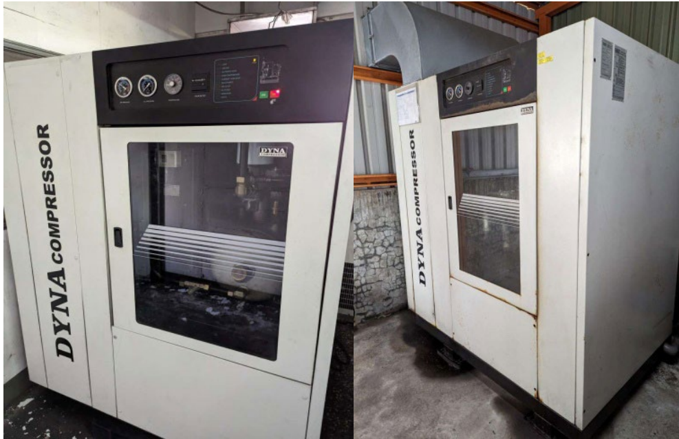
汰舊換新高效能空壓機，提升將近14%的功率
